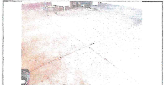
Foto 2: Piso en mal estado
